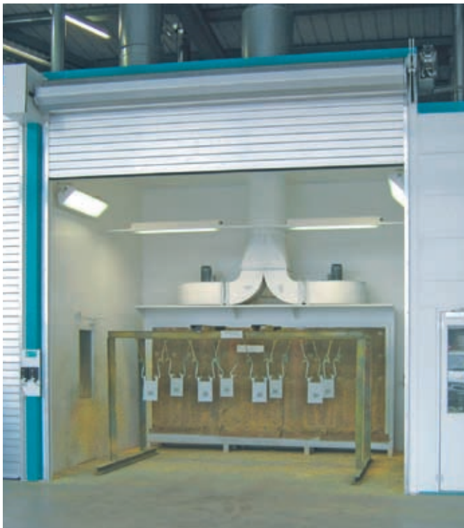
Lackierkabine für kleinere Objekte mit eingebauter Spritzwand
